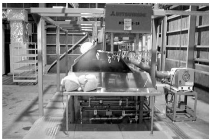
試験運用中の種籾温水消毒施設（一部）
