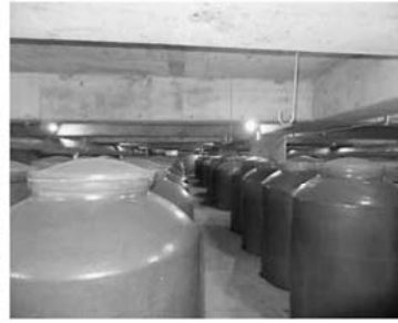
札幌酒精工業(株)厚沢部工場の地下貯蔵罐
