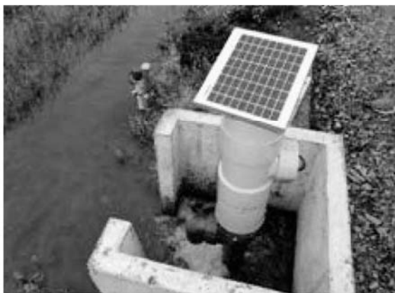
制御装置を取り付けた給水バルブ
